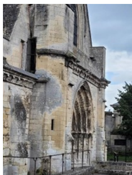
Figure 3 : Le portail, sa galerie de pierre et les 2 renforts latéraux inutiles
