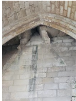
Figure 15 : conduit de cheminée
